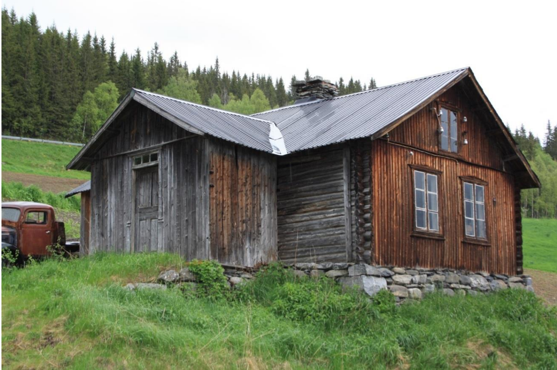
Figur 157. Kårhuset på garden står i opphavleg tilstand, men har mykje røteskadar.
