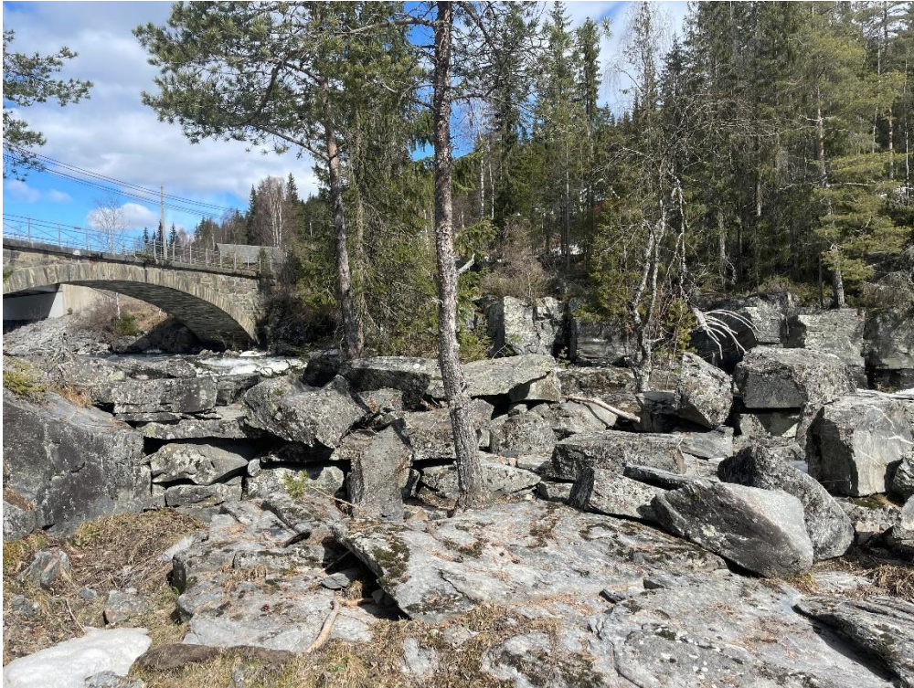
Figur 100. Ei mur mot vassdraget vart rast under uvêret Hans i 2023.
