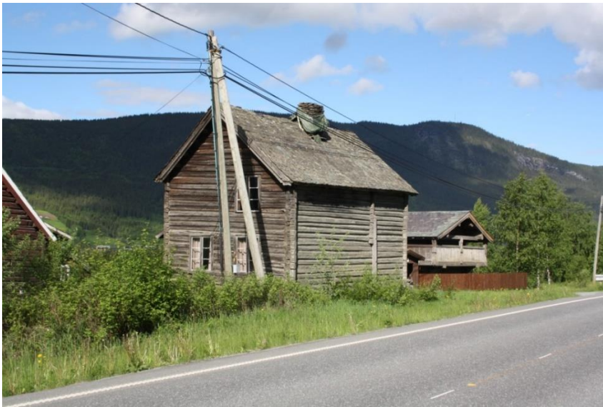
Figur 141. Kårbustad. Mast og leidning ligg heilt inntil bygget
